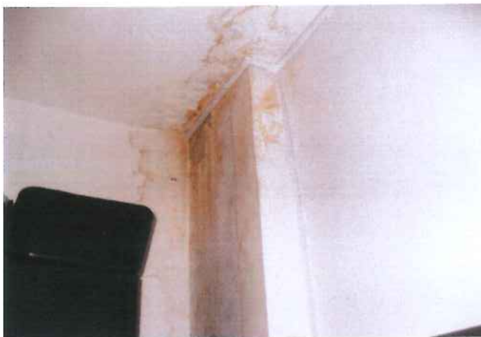
fot. 61. Kolejne ślady starych zacieków w pokoju biurowym przy wschodniej ścianie zewnętrznej na poziomie II piętra budynku
