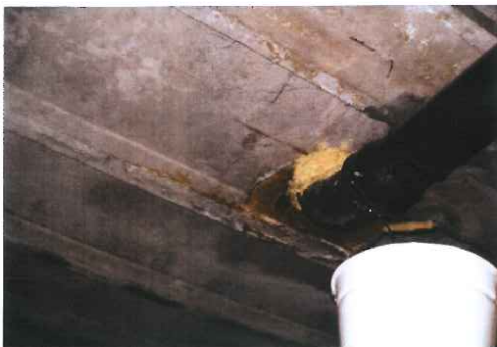
fot. 64. Nieszczelna, z podwieszonym wiadrem zbierającym wyciekającą wodę rura kanalizacji deszczowej przechodząca przez dach budynku w przestrzeni nad sufitem widowni, widoczne zawilgocenie płyt i korozja ich zbrojenia wewnętrznego
