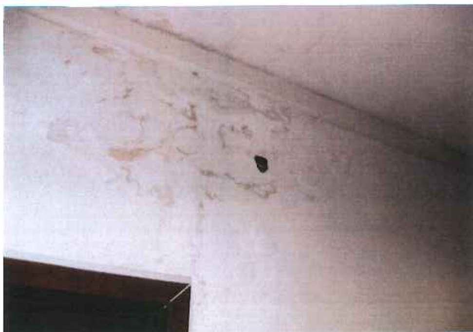
fot. 60. Zacieki na tynku ściany podłużnej korytarza po wschodniej stronie II piętra budynku
