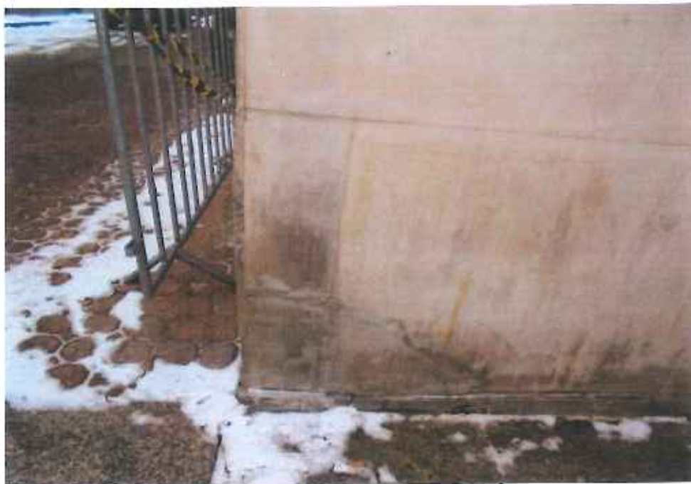
fot. 71. Zatarte pęknięcie dolnego fragmentu elewacji wschodniej w południowo-wschodnim narożu budynku
