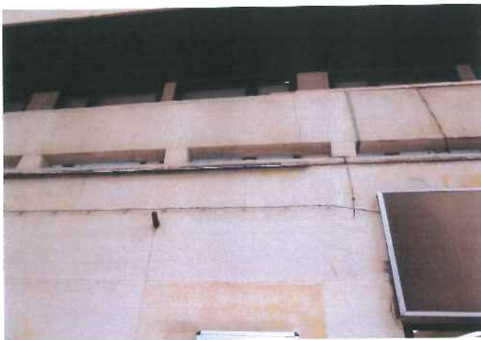
fot. 69. Pęknięta w dwóch miejscach płyta okładziny elewacji południowej przy wejściu głównym wejściu do budynku teatru
