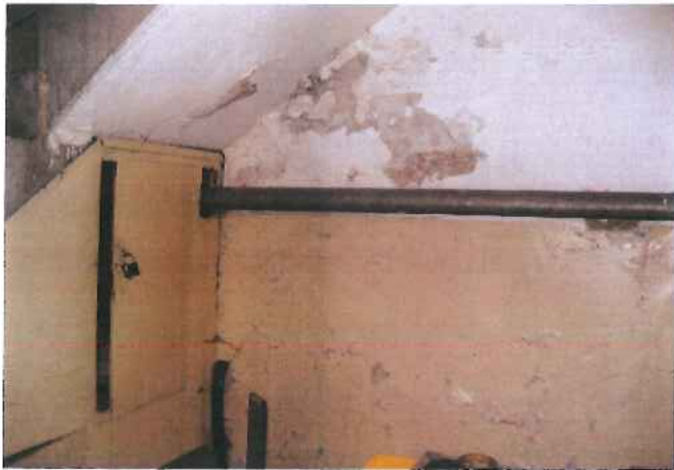
fot. 5. Zawilgocenie ścian dolnego poziomu klatki schodowej przy zewnętrznej ścianie zachodniej
