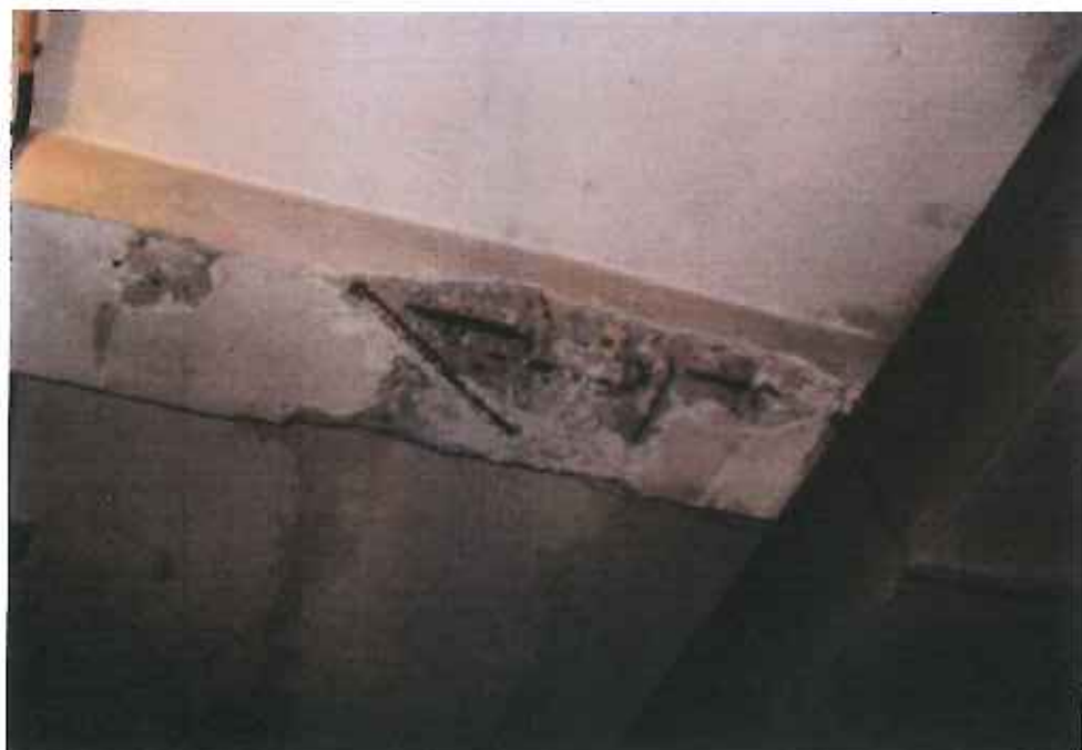
fot. 26. Odsłonięte zbrojenie jednego z podciągów piwnicznego stropu nad pomieszczeniem wentylatorni w południowo – zachodniej części piwnic budynku
