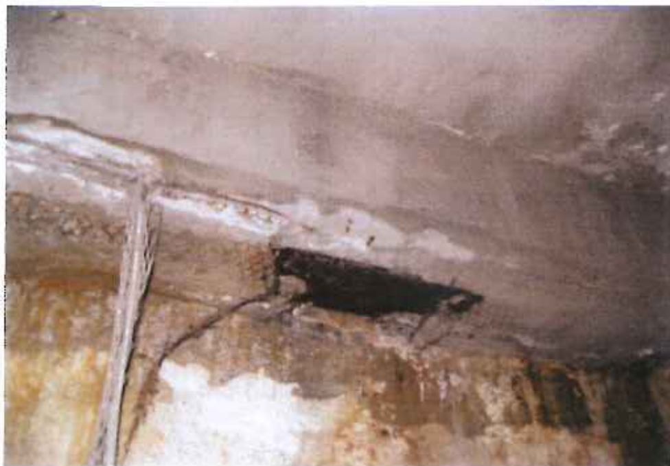
fot. 24. Ubytek tynku odsłaniający skorodowany płaskownik wzmacniający rozciąganą strefę belki stropu nad magazynem usytuowanym pod podwórkiem wewnętrznym posesji
