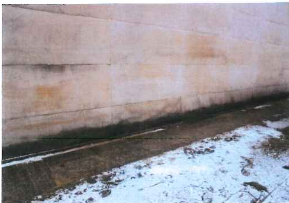
fot. 72. Nalot glonów na dolnym fragmencie zachodniej elewacji budynku – konsekwencja braku cokołu
