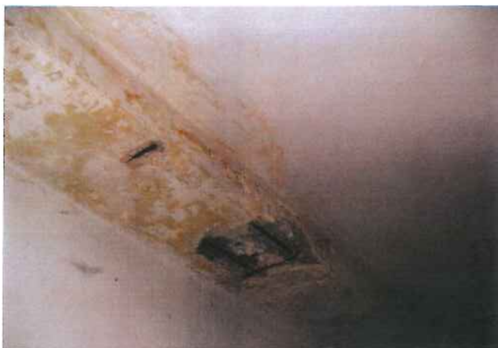
fot. 16. Odłonięte w wyniku odpadnięcia otuliny zbrojenie podciągu stropowego w kolejnym z piwnicznych pomieszczeń magazynowych po wschodniej stronie budynku
