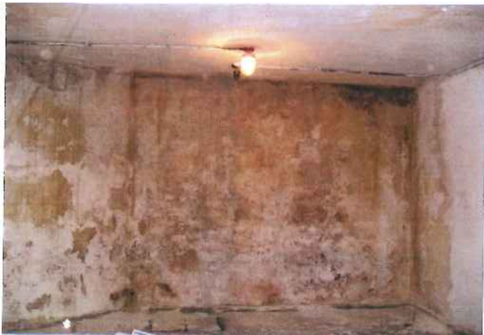
fot. 10. Zniszczony przez wilgoć tynk zewnętrznej ściany piwnicznej w pomieszczeniu TSKŻ po południowej stronie budynku
