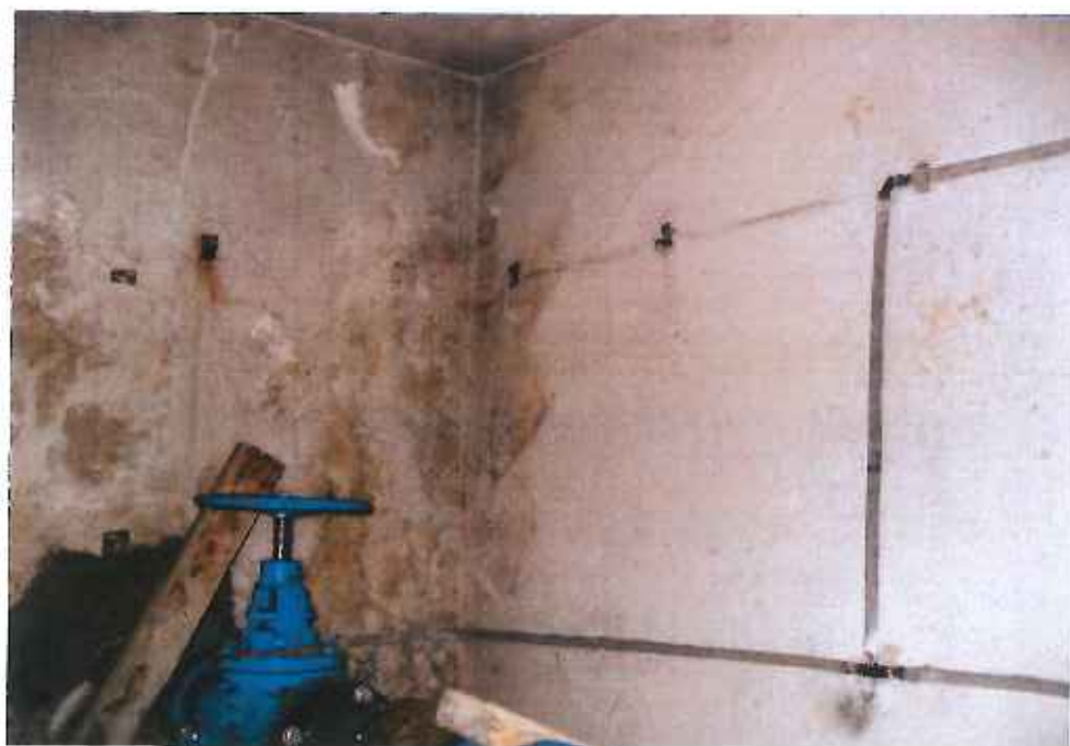
fot. 32. Zniszczone przez wilgoć tynki i ukośna rysa ściany poprzecznej w piwnicznym pomieszczeniu wodomiaru
