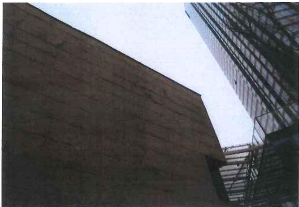
fot. 66. Uszkodzenia licowej warstwy płyt piaskowcowej okładziny zachodniej elewacji budynku
