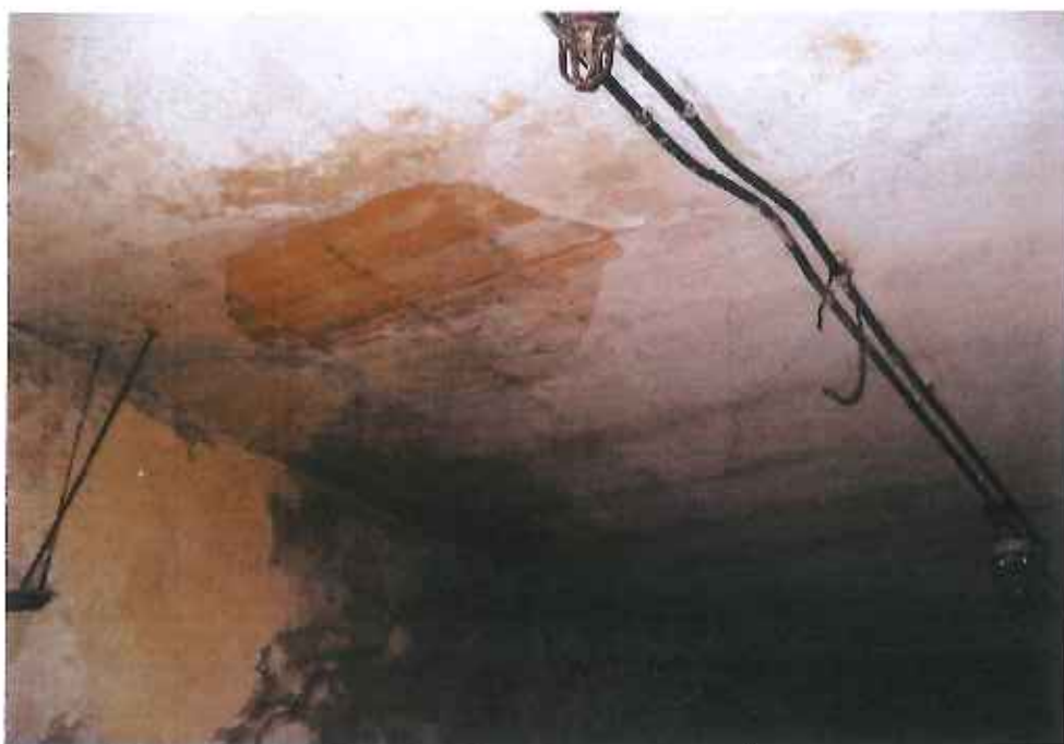
fot. 14. Mokra, zagrzybiona ściana i odpadający tynk stropu nad pomieszczeniem piwnicznym po wschodniej stronie budynku
