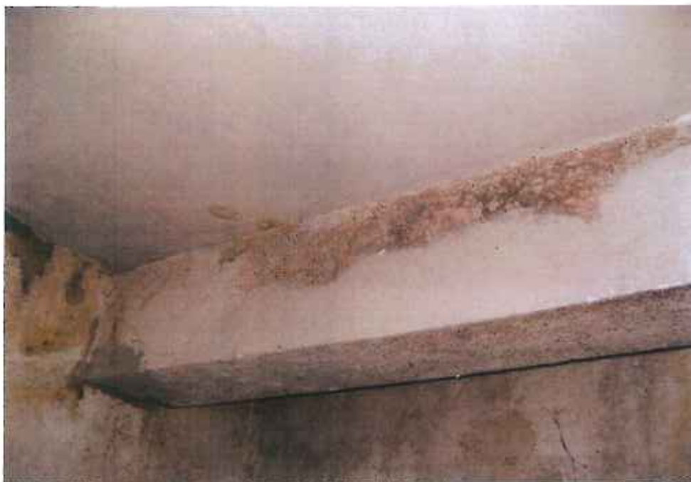
fot. 21. Rozwinięte kolonie grzyba budowlanego na ścianie i stropie nad piwnicznym korytarzem po wschodniej stronie pomieszczeń magazynowych
