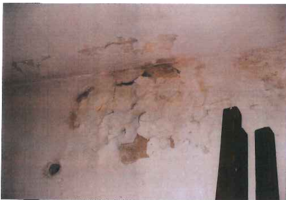
fot. 11. Zniszczony przez zawilgocenie tynk fragmentu piwnicznej ściany zewnętrznej w kolejnym z piwnicznych pomieszczeń magazynowych po wschodniej stronie budynku
