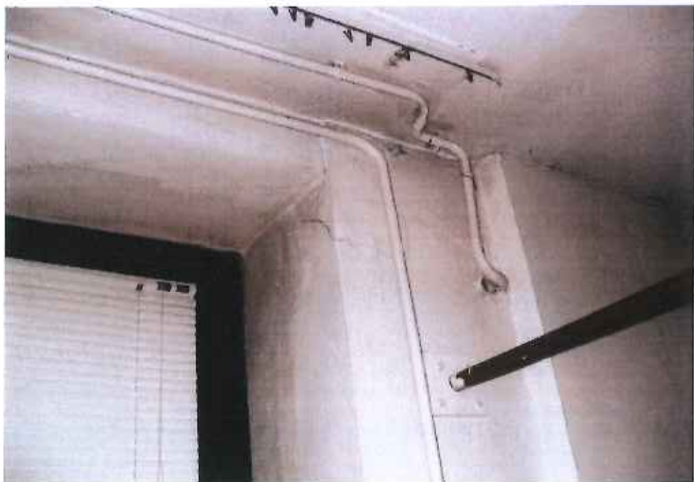
fot. 39. Spękania muru ściany zewnętrznej przy oknie sali baletowej na II piętrze budynku
