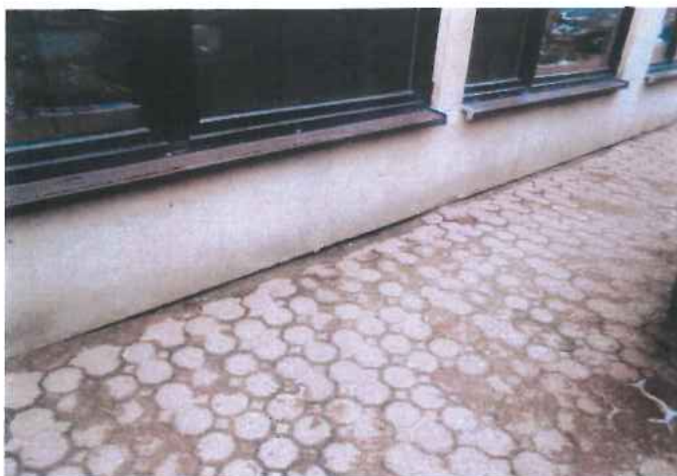
fol. 77. Zapadnięcia kostkowej nawierzchni chodnika przylegającego do południowej elewacji budynku
