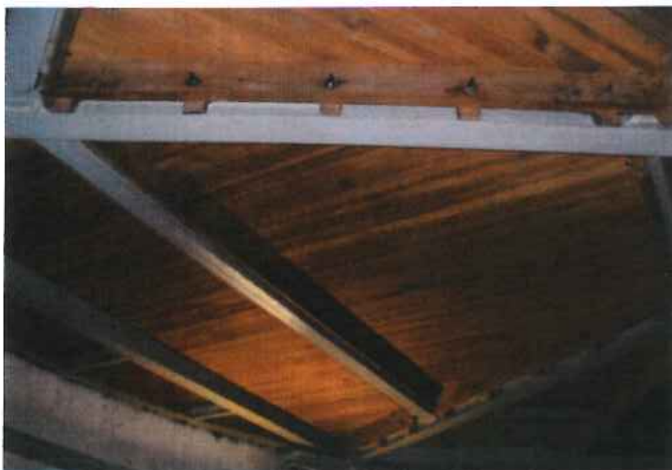
fot. 36. Widoczne nadmierne ugięcia desek podłogowych sceny teatru
