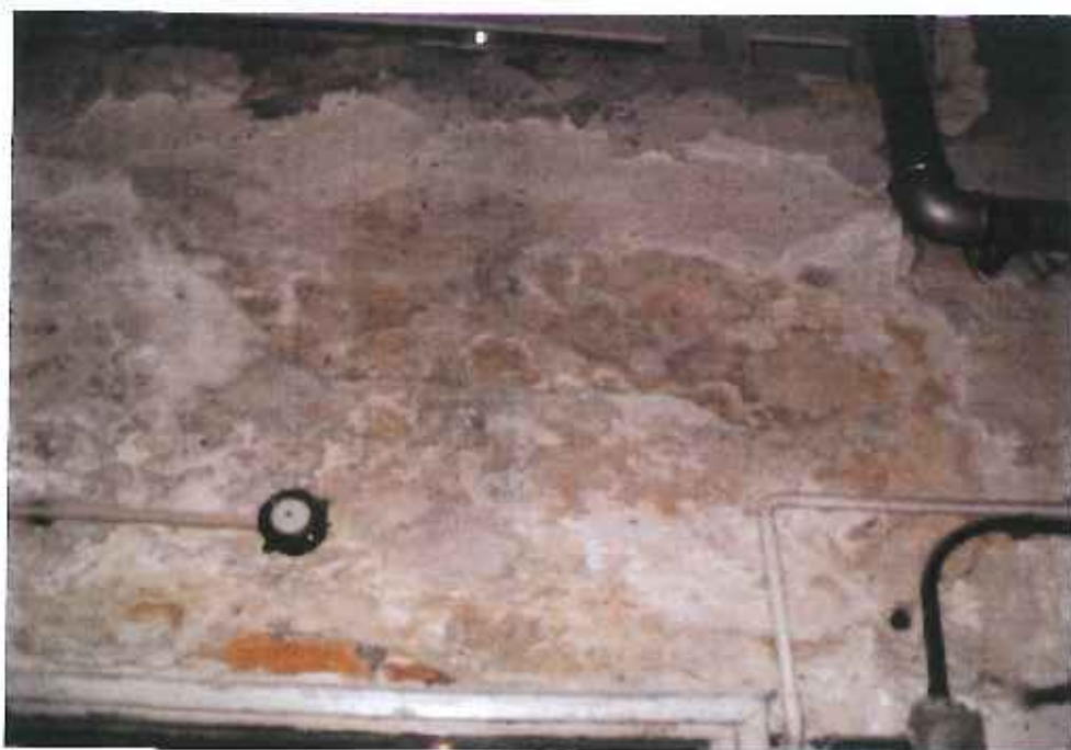
fot. 12. Zniszczony przez wilgoć tynk zewnętrznej ściany piwnicznej w korytarzu przy pomieszczeniach magazynowych
