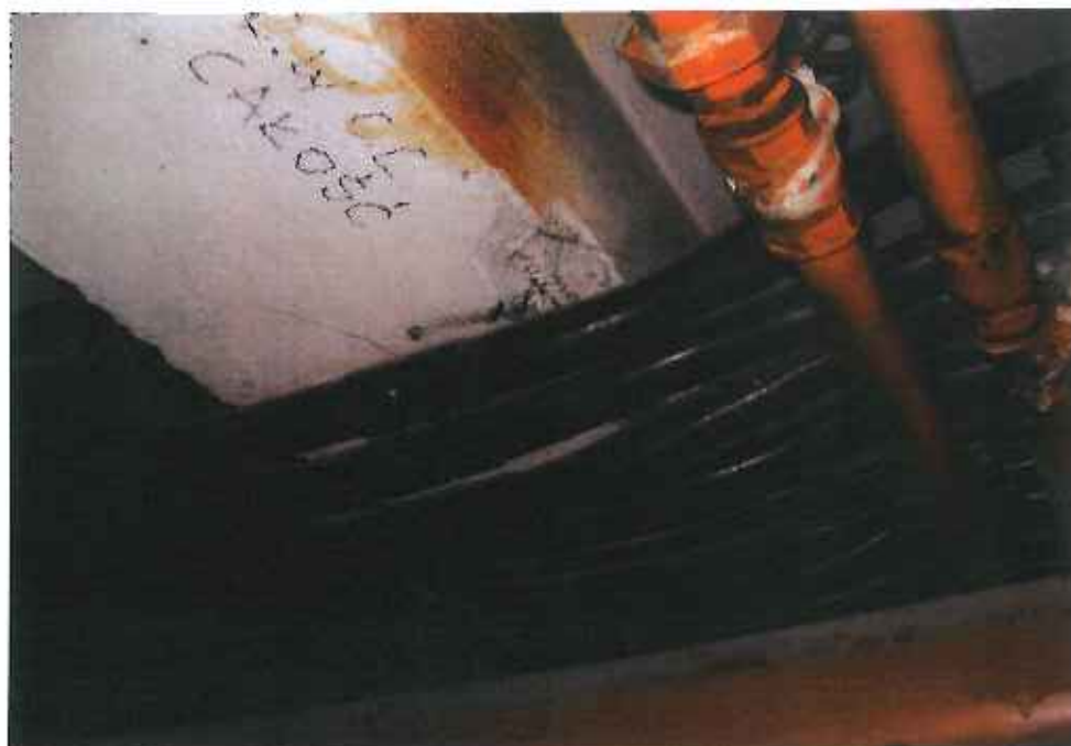
fot. 29. Rozkuta krawędź podciagu stropowego nad korytarzem po północnej stronie ciągu pomieszczeń magazynowych
