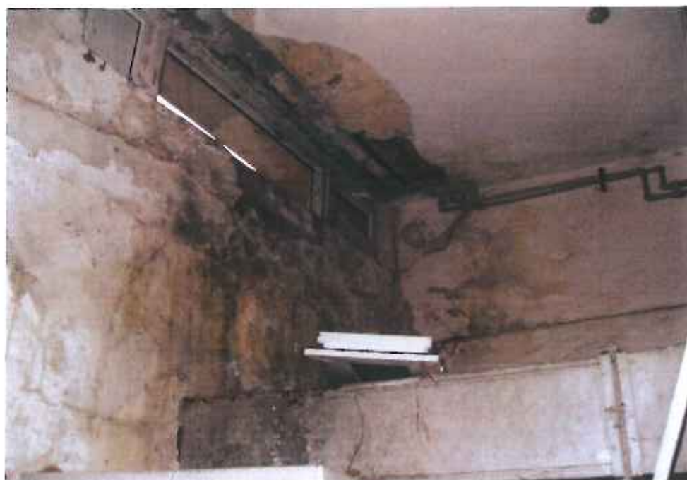
fot. 13. Mokry strop i ściana zewnętrzna w piwnicznym pomieszczeniu starej wentylatorni, miejscowa destrukcja stropu Akermana
