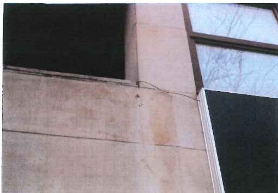
fot. 68. Spękania płyt kamiennej okładziny przy południowej krawędzi elewacji wschodniej
