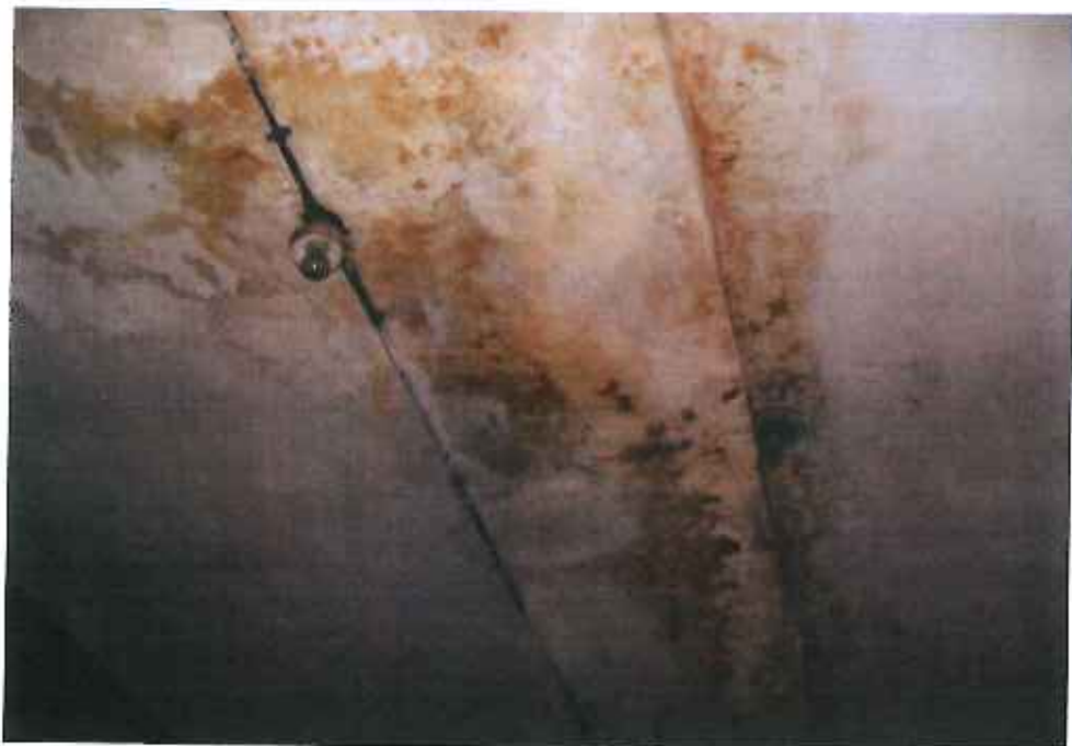
fot. 20. Mokry, z nalotem zagrzybienia fragment stropu nad jednym z piwnicznych magazynów po południowej stronie wentylatorni
