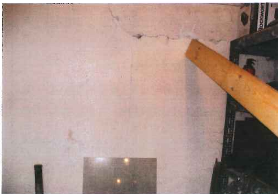
fot. 30. Spękania tynku ściany poprzecznej w piwnicznym pomieszczeniu ślusarni
