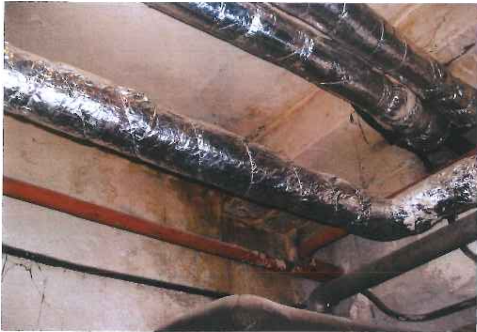
fot. 9. Zacieki na tynku ściany i sufitu w piwnicznym pomieszczeniu północno – wschodniego naroża budynku
