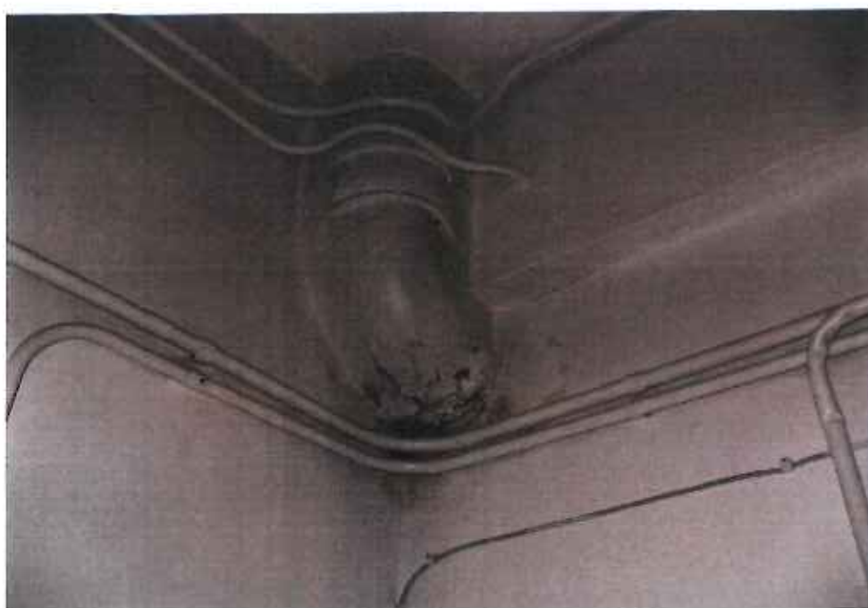
fot. 62. Ślady nieszczelności rury kanalizacji deszczowej w narożu pomieszczenia N/D na poziomie II piętra budynku
