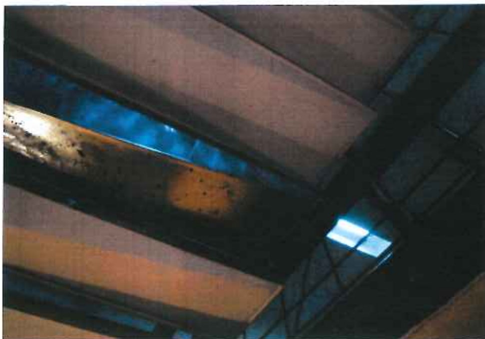
fot. 54. Okuty blachą jeden ze stopni wspornikowej klatki schodowej, dodatkowo z doraźnie dospawanym do krawędzi stalowym wspornikiem podpierającym
