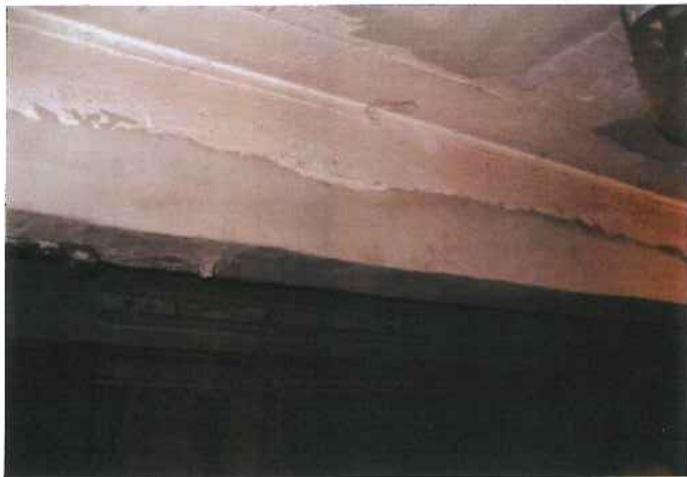
fot. 23. Ślady wykonanych reperacji żeber stropu piwnicznego pod wewnętrznym podwórkiem posesji – pomieszczenie ślusarni
