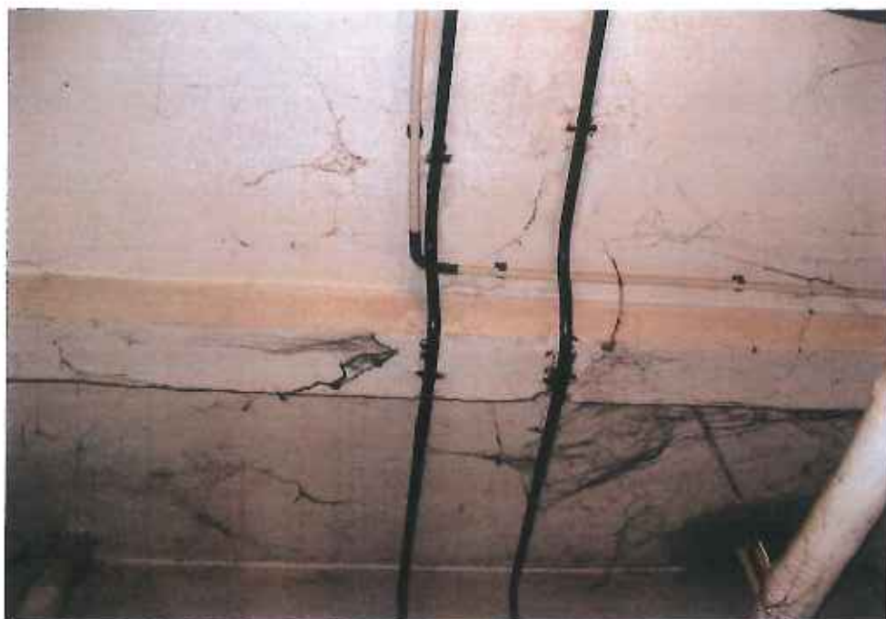
fot. 25. Rozkuta pod kablem otulina zbrojenia jednego z żeber stropu piwnicznego w pomieszczeniu magazynu elektrycznego przy podsceniu
