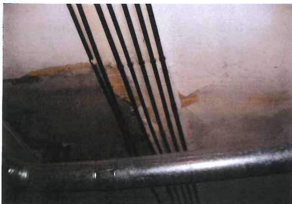
fot. 17. Ubytki tynku nad piwnicznym korytarzem po wschodniej stronie budynku
