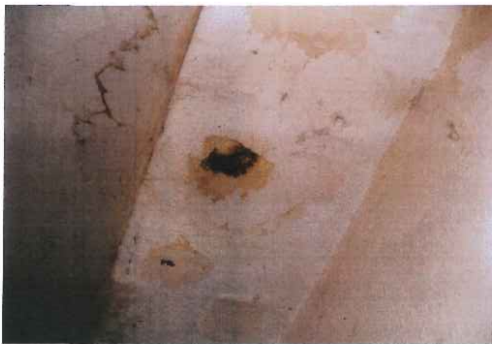
fot. 15. Korozyjny naciek na spodniej powierzchni podciągu stropowego w jednym z piwnicznych pomieszczeń magazynowych po wschodniej stronie budynku, wskazujący na zaawansowaną korozję jego wewnętrznego zbrojenia
