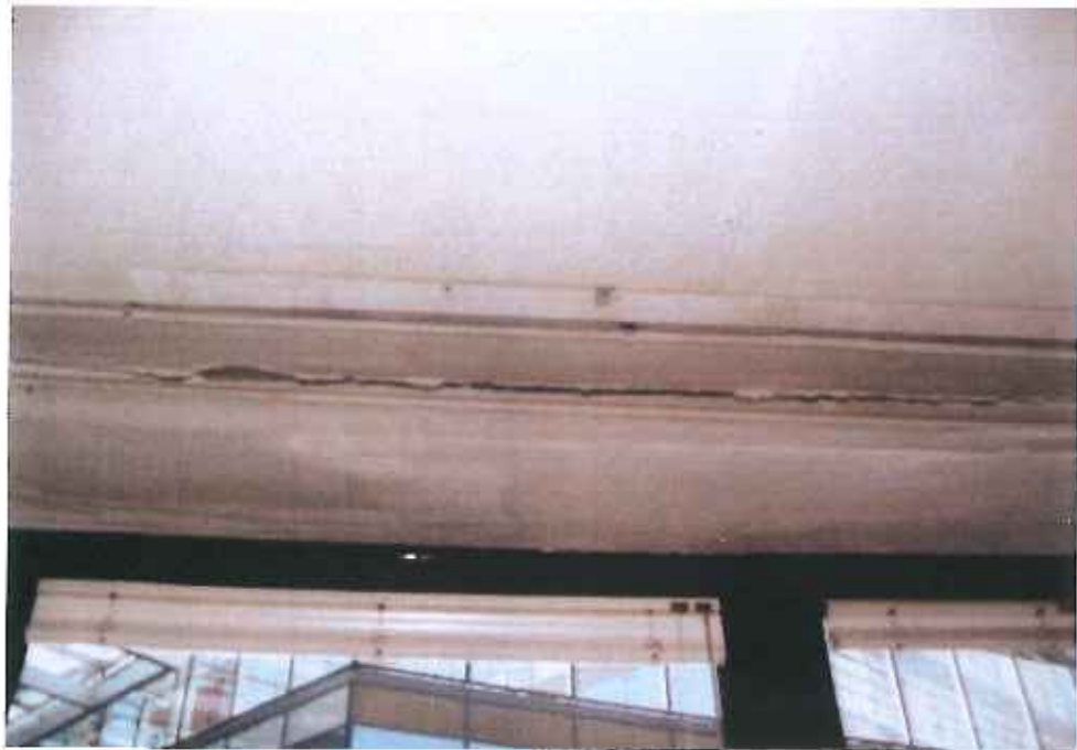
fot. 48. Ugięte nadproże okienne w pracowni krawieckiej na poziomie II piętra w południowo –wschodnim narożu budynku
