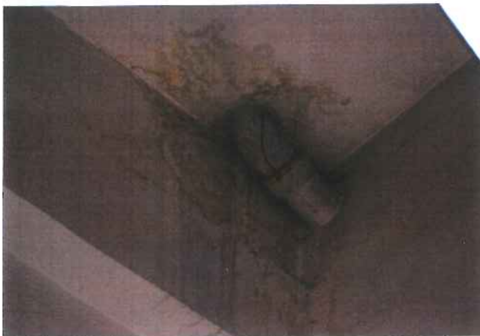
fot. 63. Pęknięta rura kanalizacyjna w narożu zachodniej klatki schodowej w poziomie pod dachem budynku
