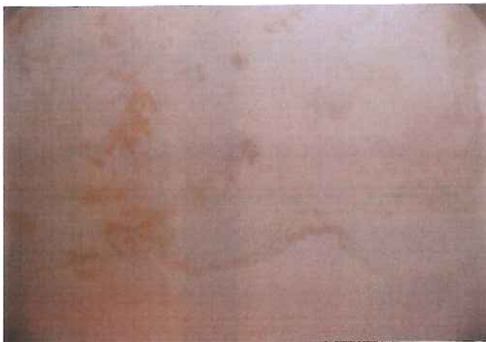
fot. 59. Zacieki na tynku sufitu w skrajnym północnym pomieszczeniu biurowym na poziomie II piętra budynku
