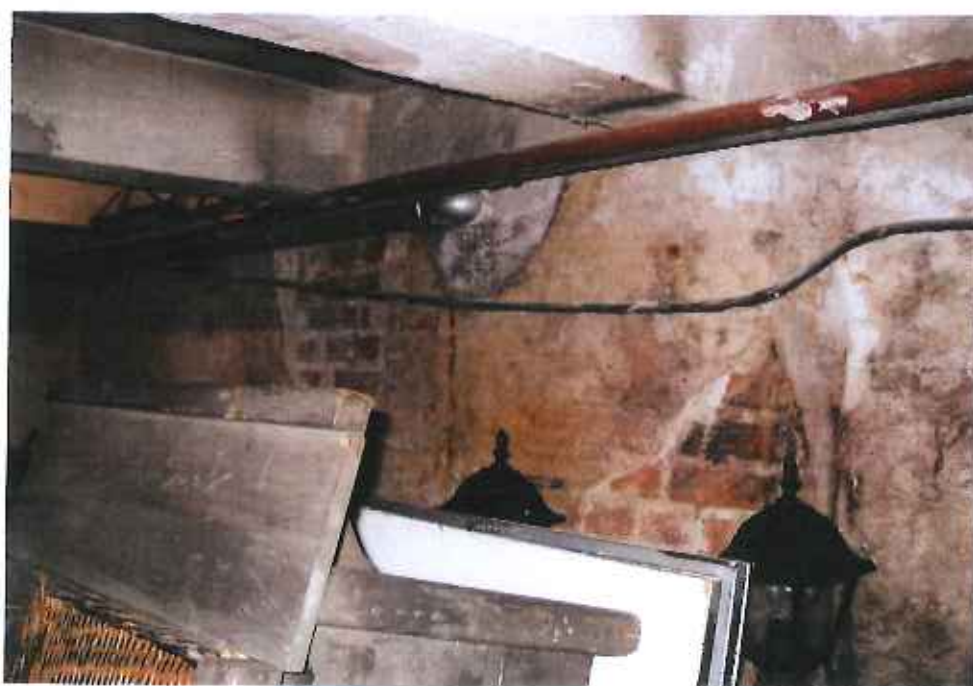
fot. 2. Całkowicie zniszczony przez wilgoć tynk wewnętrznej ściany piwnicznej w pomieszczeniu magazynu pod podwórką wewnętrzną posesji
