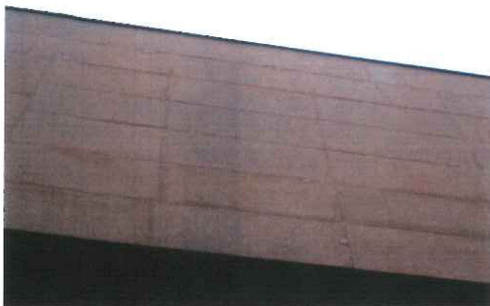
fot. 67. Widoczne ślady napraw i uzupełniania ubytków płyt kamiennej okładziny południowej elewacji budynku
