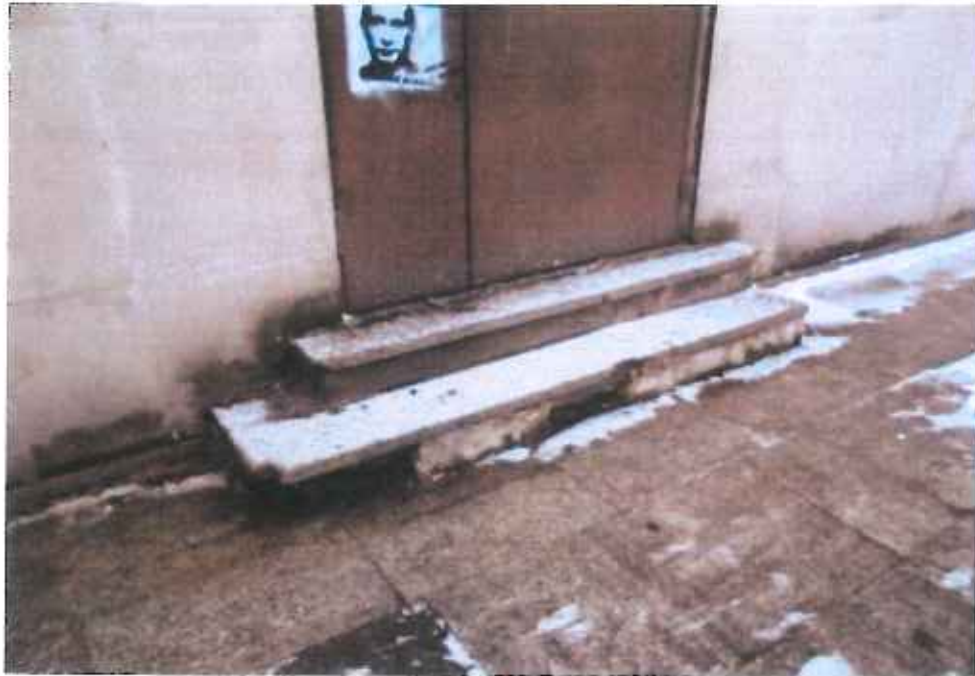
fot. 75. Kolejne zniszczone schodki dodatkowego wyjścia z przestrzeni widowni w zachodniej elewacji budynku
