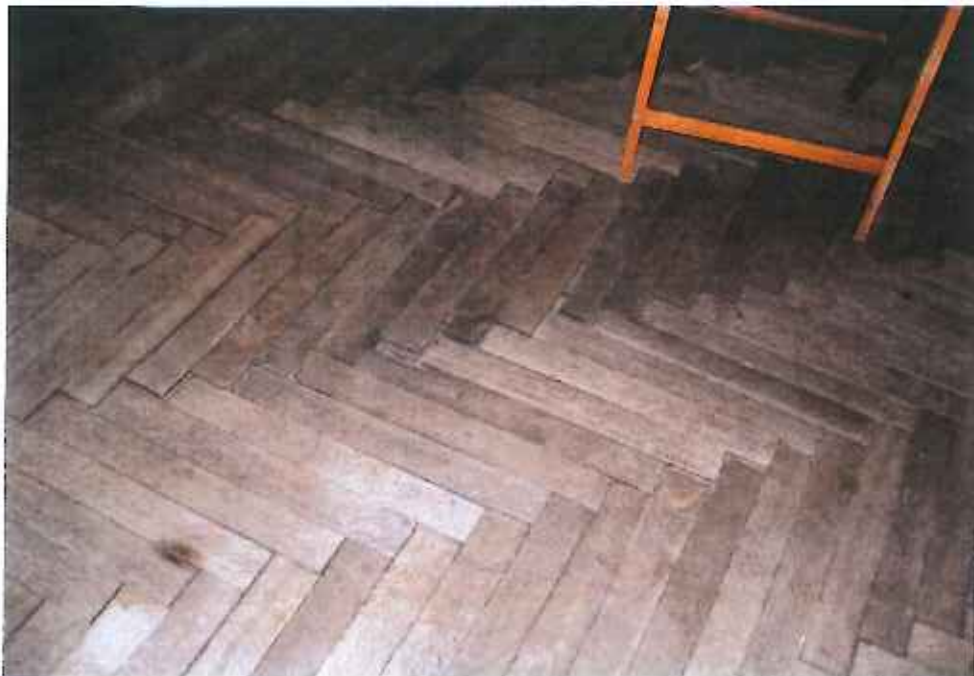
fot. 65. Mocno wyeksploatowana klepka nawierzchni podłogowej sali baletowej na II piętrze budynku
