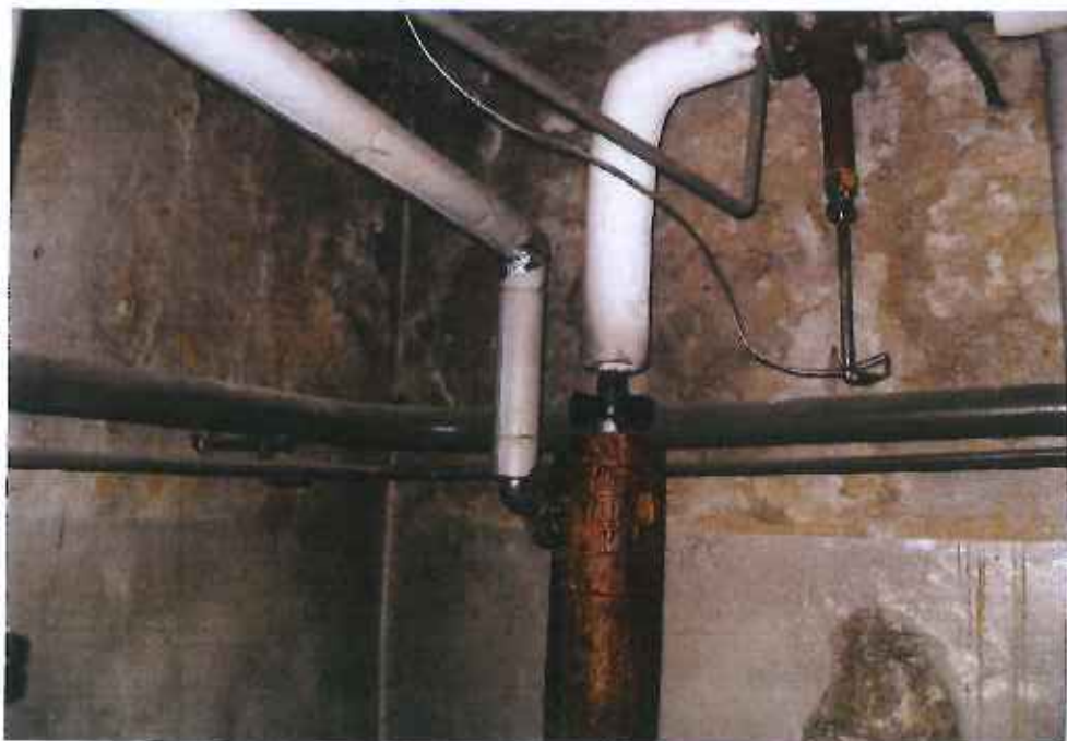
fot. 6. Spowodowana zawilgoceniem destrukcja tynków w narożu pomieszczenia węzła cieplnego w piwnicach budynku
