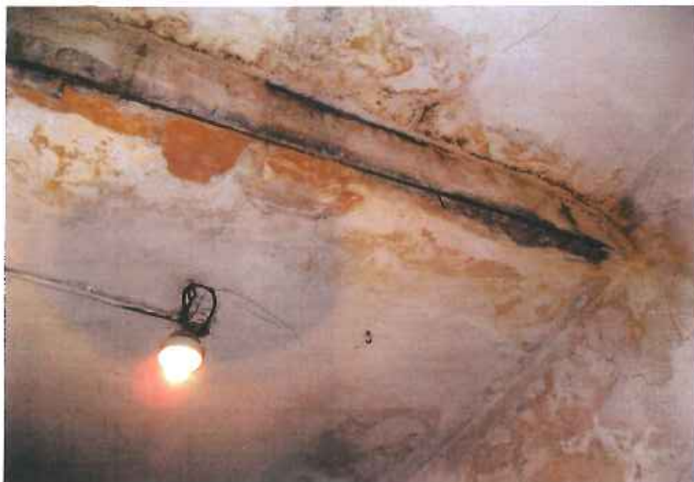
fot. 18. Odslonięte skorodowane zbrojenie mokrego stropu nad skrajnym, południowo – zachodnim pomieszczeniem piwnicznym
