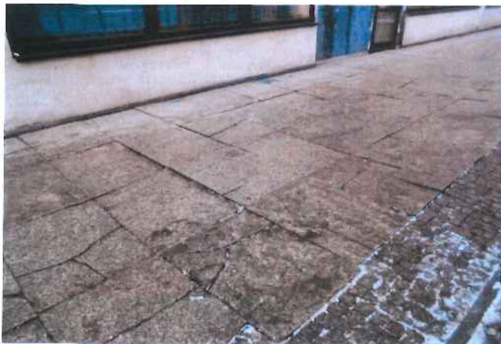
fot. 76. Popękane i pozapadane płyty chodnika poprowadzonego wzdłuż frontowej, wschodniej elewacji budynku
