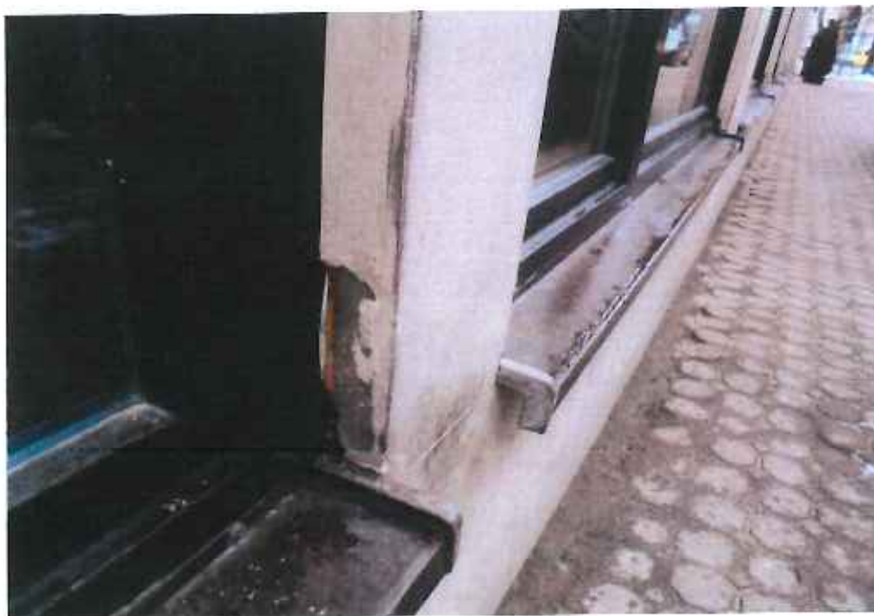
fot. 70. Uszkodzenie ościeża skrajnego zachodniego okna parteru elewacji południowej
