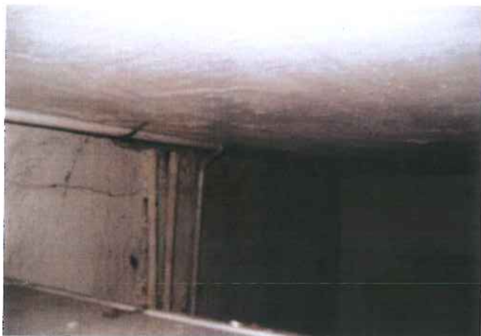
fot. 31. Poziome pęknięcie zawilgoconej ściany piwnicznego pomieszczenia starej wentylatorni
