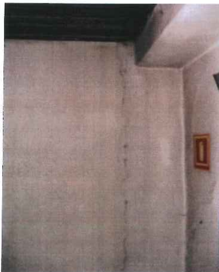
fot. 40. Spękania muru w narożu ściany zewnętrznej i wewnętrznej przy oknie sali baletowej na II piętrze budynku
