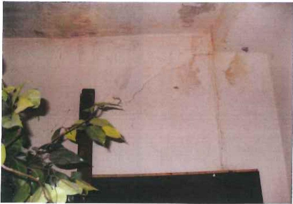
fot. 33. Ukośne pęknięcie ściany poprzecznej w piwnicznym pomieszczeniu magazynowym po wschodniej stronie budynku
