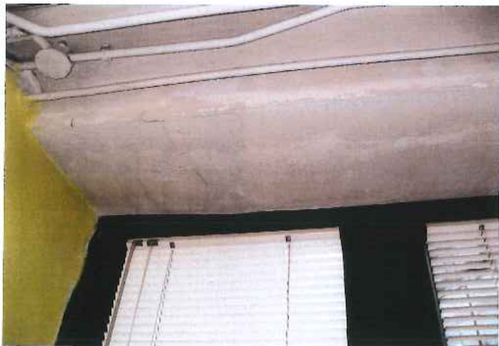
fot. 49. Ugięte, spękanе nadproże okienne w kabinie akustycznej na poziomie II piętra w południowo –wschodnim narożu budynku
