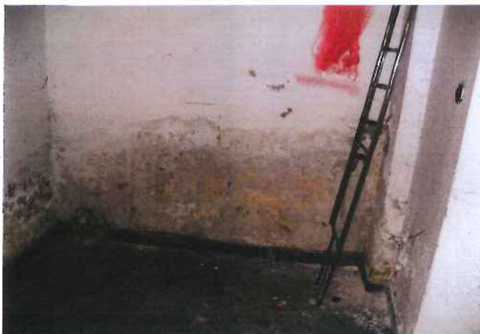
fot. 7 i 8. Zawilgocone, zniszczone tynki ściany podłużnej korytarza po północnej stronie ciągu pomieszczeń magazynowych, fragment pod stropem i nad posadzką
