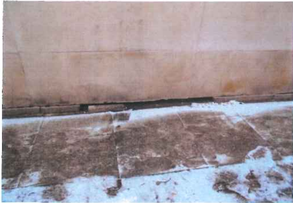
fot. 73. Zniszczenie styku zachodniej elewacji budynku z przyległym fragmentem chodnika, ubytki elementu podwalinowego
