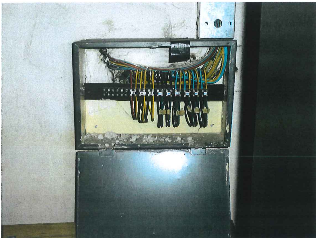
Fot. nr 17 – Rozdzielnia oświetleniowa. Brak zachowanej ochrony podstawowej złącza. Nieprawidłowe kolory przewodów zasilających.
