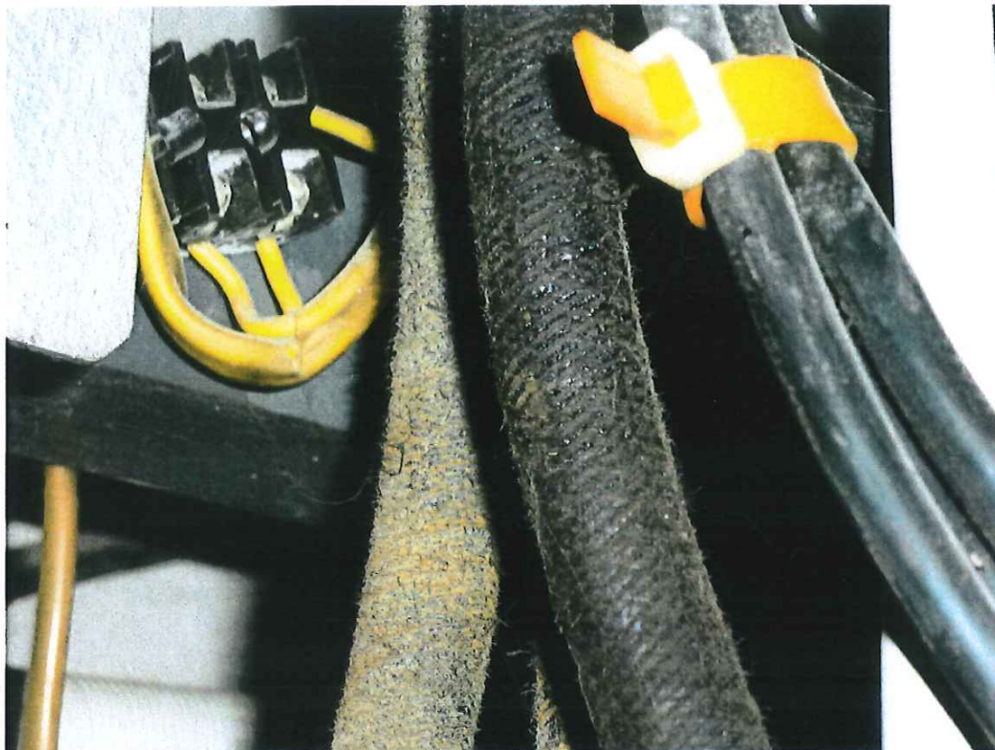
Fot. nr 15 – Rozdzielnica główna. Przewód zasilający „spocony”.
