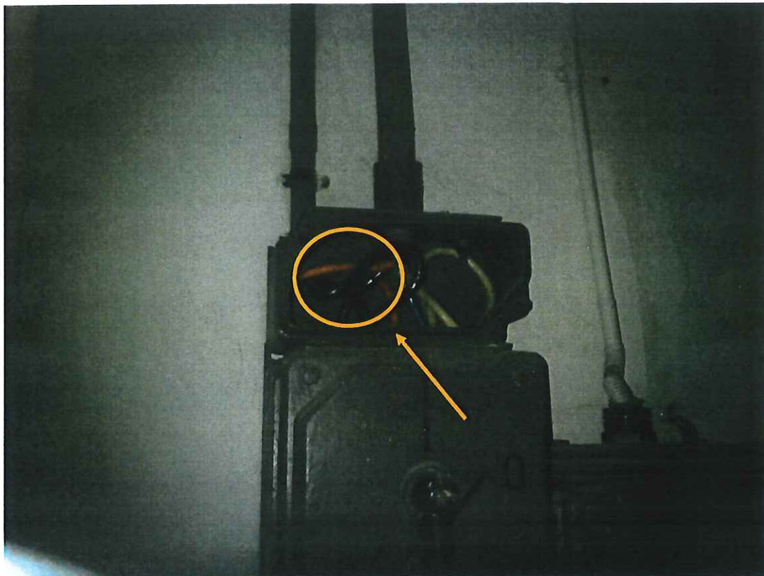
Fot. nr 25 – Rozdzielnica muzyczna. Nieprawidłowe kolory przewodów zasilających.
