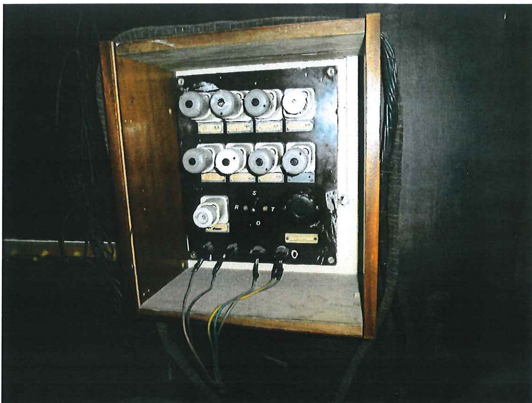
Fot. nr 5 – Zaplecze dużej sceny. Brak zachowanej ochrony podstawowej rozdzielnicy.
