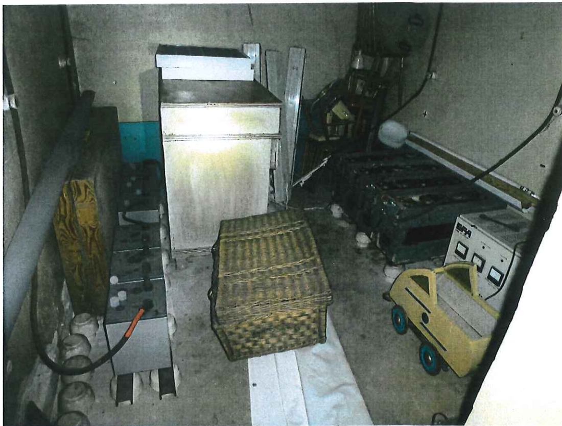
Fot. nr 23 – Akumulatorownia. Zbędne rzeczy w pomieszczeniu, które podnoszą obciążenie ogniowe w pomieszczeniu.
