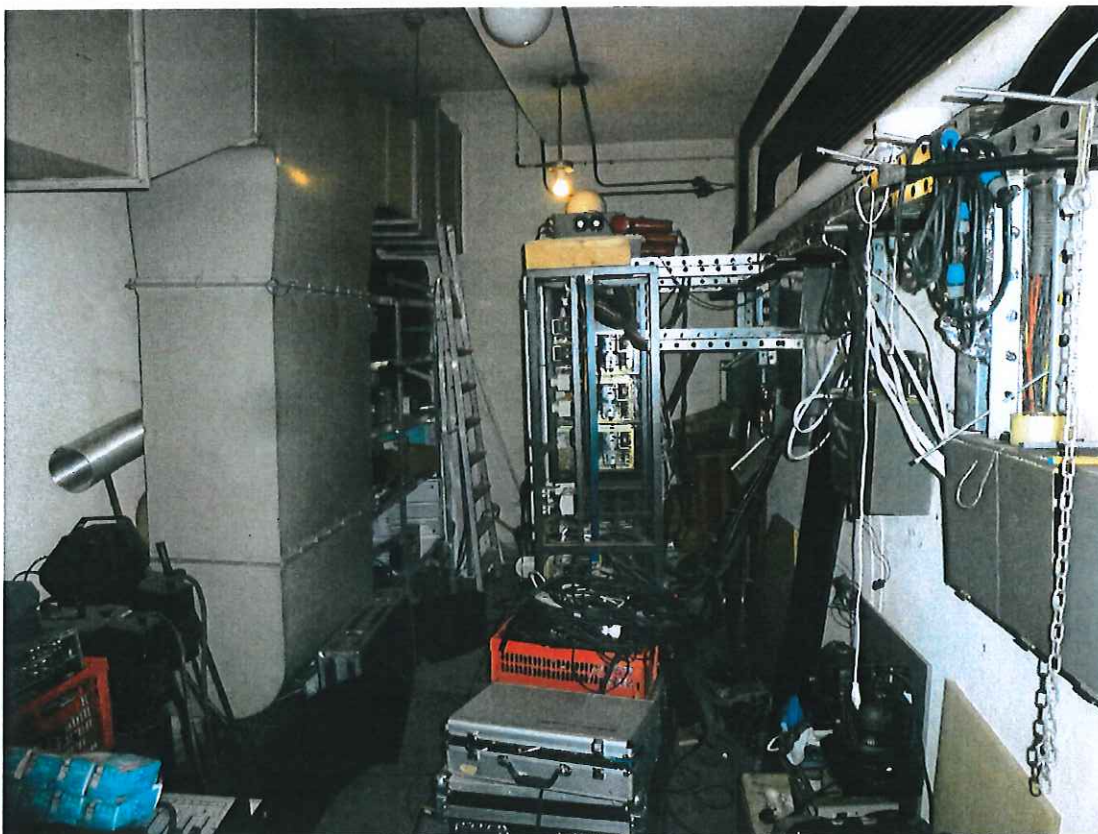
Fot. nr 20 – Rozdzielnia oświetleniowa. „Magazynek” w pomieszczeniu rozdzielni oświetleniowej.
