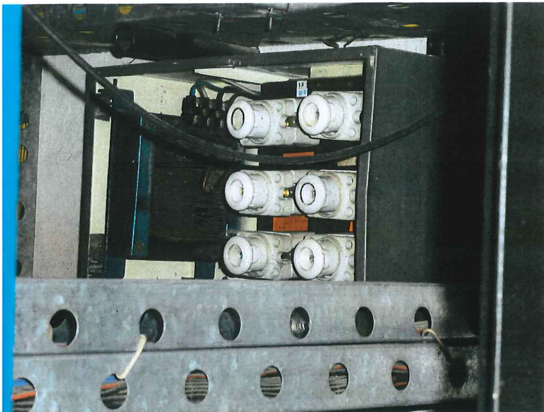
Fot. nr 19 – Rozdzielnia oświetleniowa. Brak zachowanej ochrony podstawowej.
