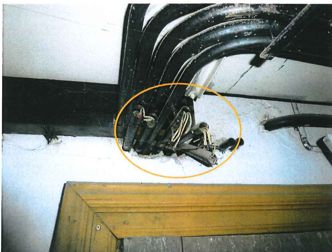
Fot. nr 8 – Korytarz obok rozdzielni głównej. Niezaizolowane przewody elektryczne.
