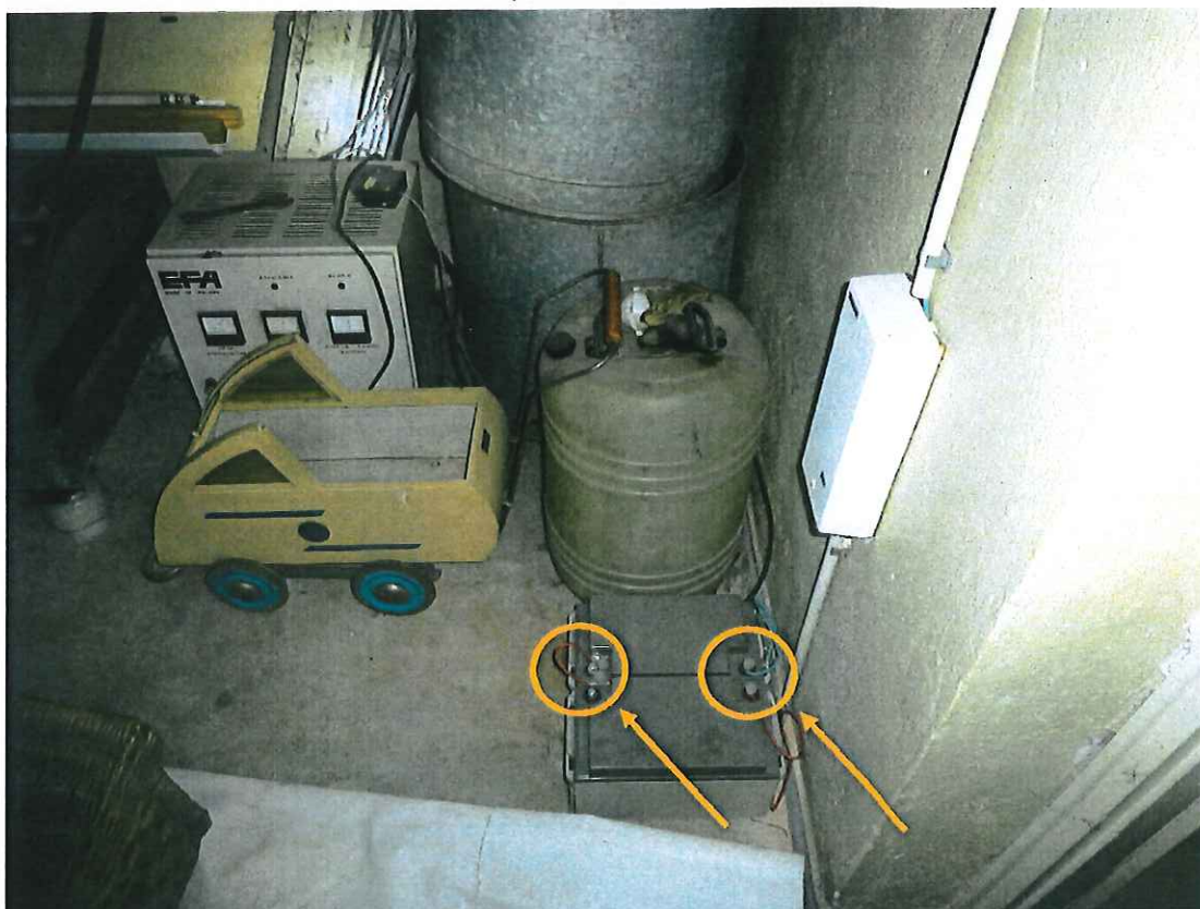
Fot. nr 24 – Wentylatorownia. Zaśniedziałe połączenia akumulatorów, nieprawidłowe wykonanie połączenia akumulatorów oraz nieprawidłowy kolor użytych przewodów.
