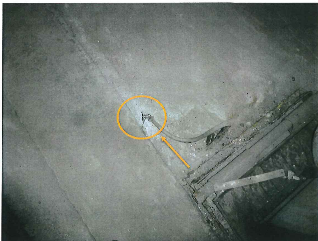
Fot. nr 22 – Wentylatorownia. Niezaizolowane oraz niezabezpieczone przewody zasilające.
