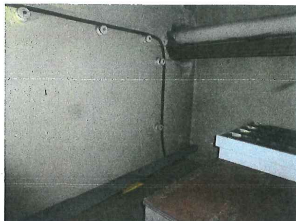
.Rury bez przepustów pożarowych.
