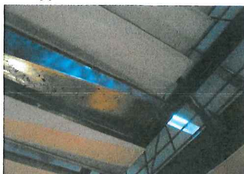
Bieg schodów K1 bez zabezpieczeń o nieznannej odporności ogniowej
