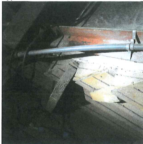
Detal sufitu podwieszonego z drewna bez jakichkolwiek zabezpieczeń ogniochronnych.
