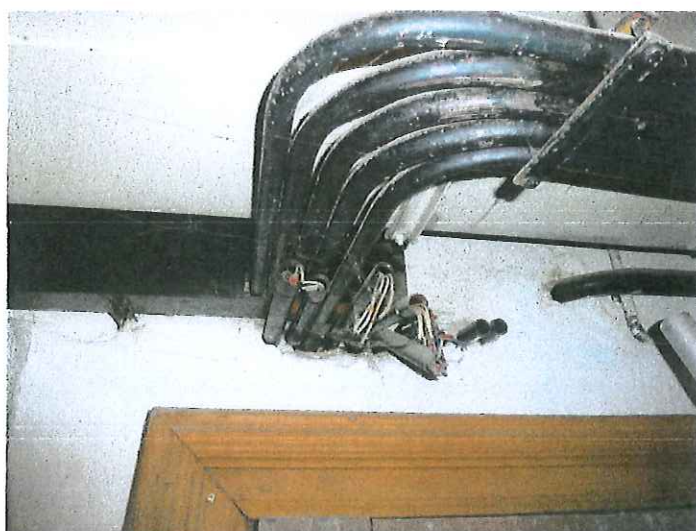
Kabel elektryczne bez przepustów pożarowych.
