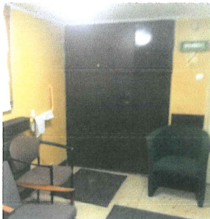
Palne meble przy wyjściu ewakuacyjnym z budynku.
